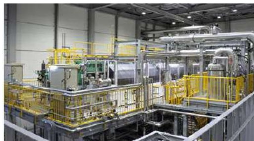
10MWの水電解装置
